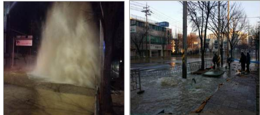
● 평택시 대형 송수관(1,000mm) 시설 노후에 의한 파손 사고 (2015-01-31)
