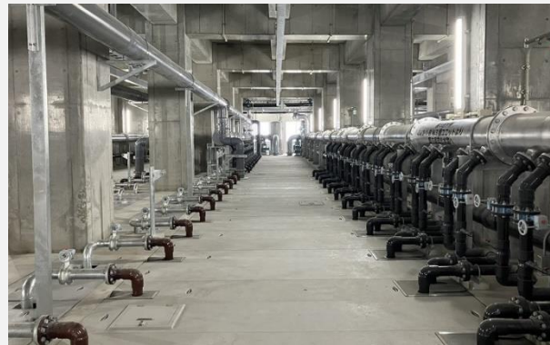
사진 2. 에비에 하수처리장 외관(상)과 내부 시설(하)
