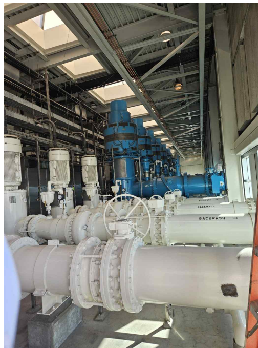
[그림] 저류조 파이프라인(흰색: 역세척수, 파란색: RO 유입수)
